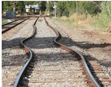
Slika 4.12. Deformacija tračnica zbog toplinske dilatacije
